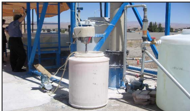
شکل ۶: نمای کلی پایلوت تصفیه خانه آب شهر بیرجند
